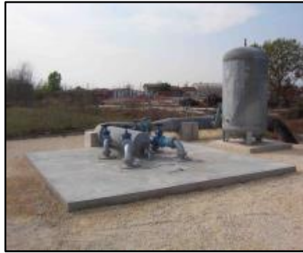
Sopra: la stazione di pompaggio del pozzo Sansughe a Cittadella; a destra: irrigazione di soccorso su mais mediante rotolone con prelievo dallo scolo Cognaro a Vigonza.
