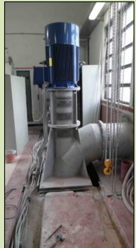
La nuova pompa da 1000 l/s installata nell'impianto di San Giuliano
