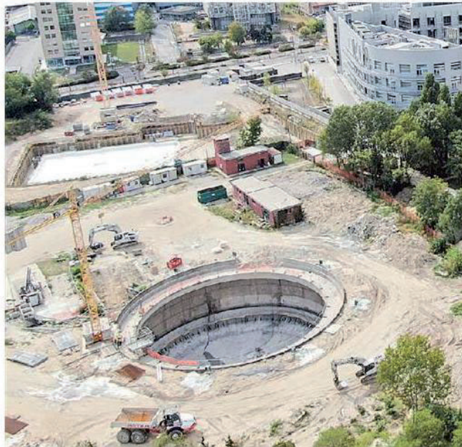
La vasca della grande idrovora di via Torino
